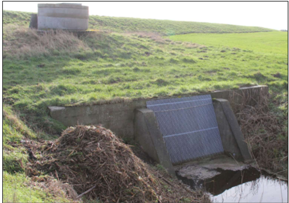
Figur 5: Pumpekanalens indløb til pumpestationen. Billede taget i østlig retning.
