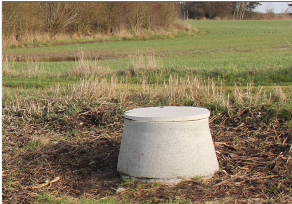
Figur 18: Betonbrønd ved indkørsel til matr.nr. 15d, Hou Ejrlav, Hou. Billede taget i nordlig retning.
